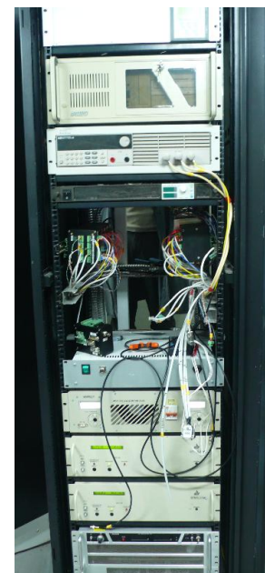
Система контроля и источники питания
